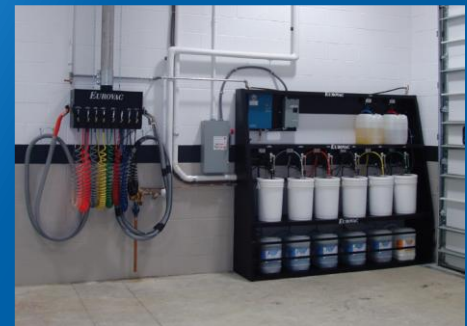
Sistema central de distribución de productos químicos
